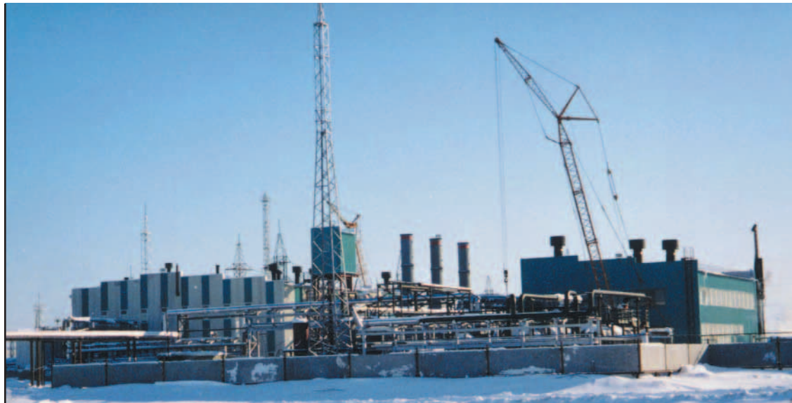
Конитлорское месторождение НК "Сургутнефтегаз". Строительство первой очереди электростанции собственных нужд мощностью 12 МВт
