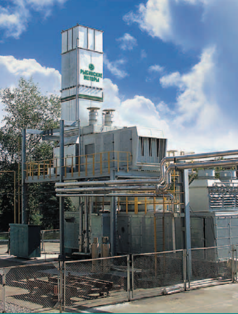
Теплоэлектростанция ГТЭС-2,5. Промплощадка ОАО "РМ".
