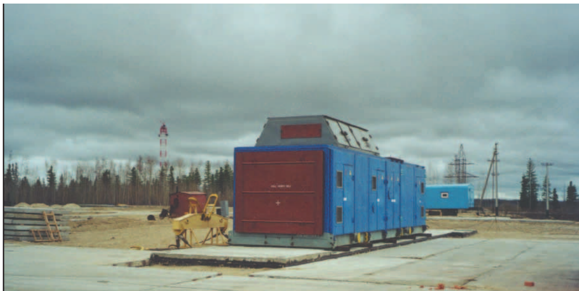
Первый энергоблок электростанции Приразломного месторождения НК "Юкос"
