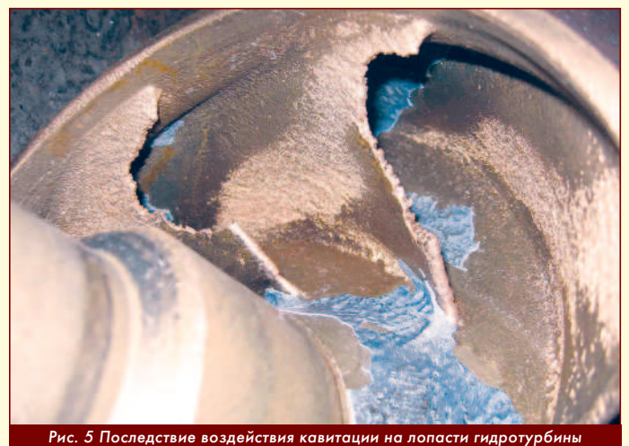
Рис. 5 Последствие воздействия кавитации на лопасти гидротурбины
